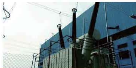
Индия: трансформатор 420kV 60MVA
