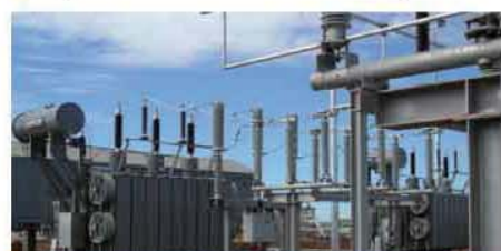
Австралия: трансформатор 132kV для ВНР
