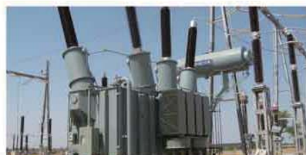
Буркина-Фасо: силовой трансформатор для Forclum
