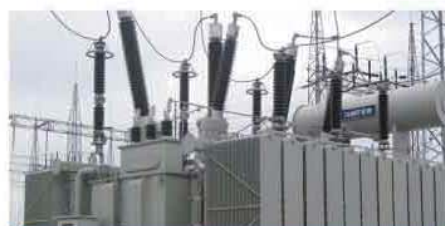
Эквадор: силовой трансформатор для CELEC S.A
